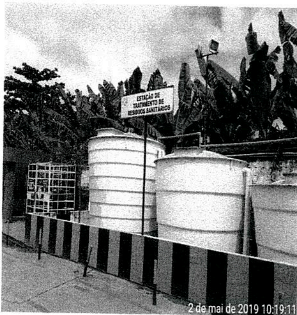
Fig.05 Estação de tratamento de resíduos sanitários
