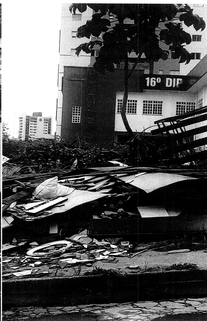
Restos do tapume de obras caídos
