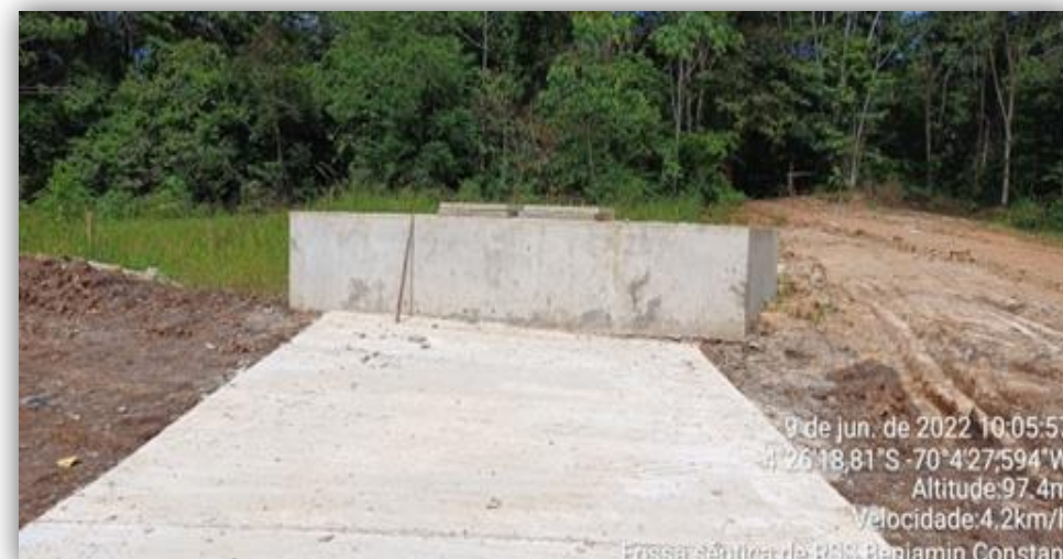
Fossa séptica construída no vazadouro de Benjamin Constant para depósito de RSS.
