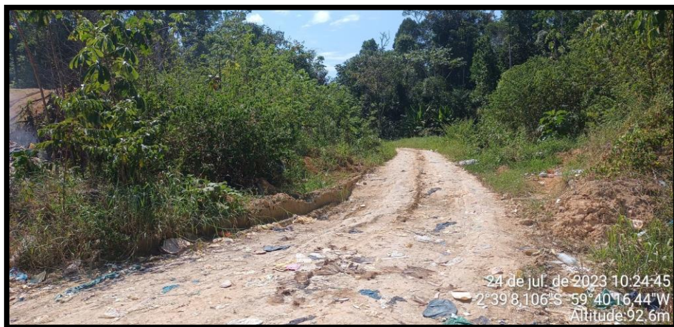
Ramal de acesso ao vazadouro municipal sem asfaltamento.
