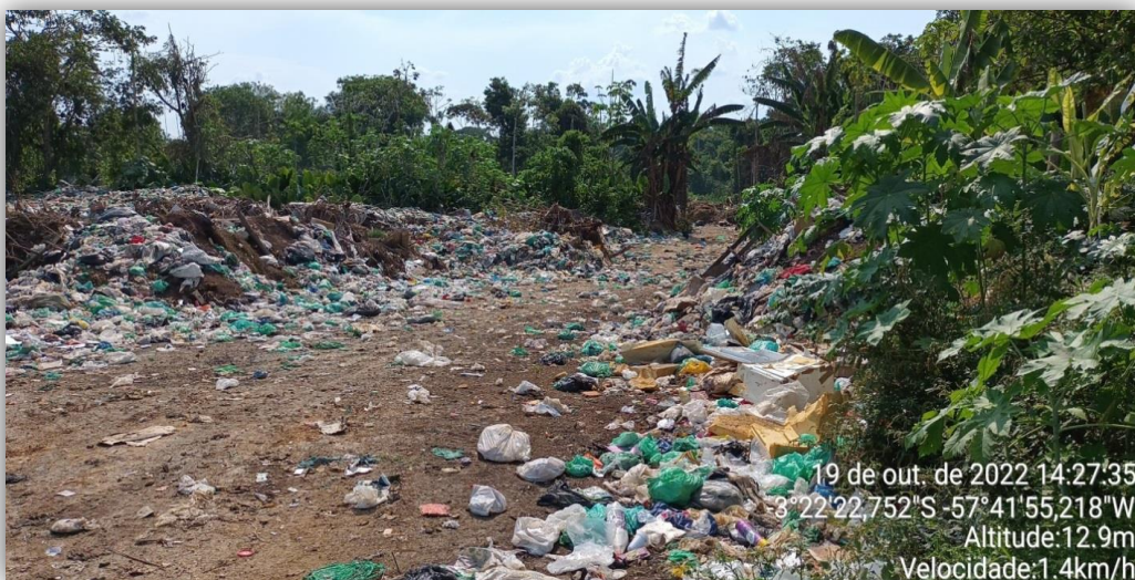
Resíduos depositados sem reconformação da massa de resíduos e posterior recobrimento desta.
