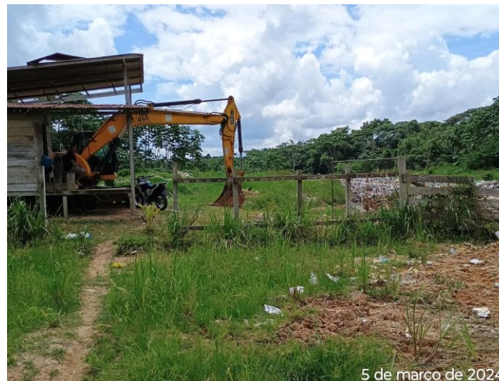
Máquina danificada possivelmente aguardando reparos.
