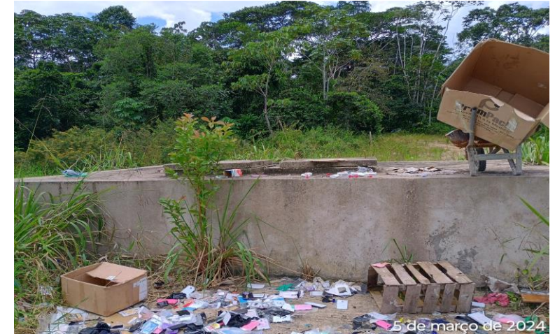
Aspecto da Fossa Séptica que vem sendo operada irregularmente, com o lançamento de resíduos que não são RSSS .
