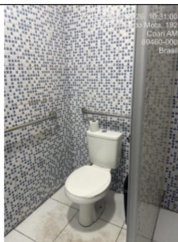
Figura 2 – Detalhe das barras de auxílio para pessoas com mobilidade reduzida.
